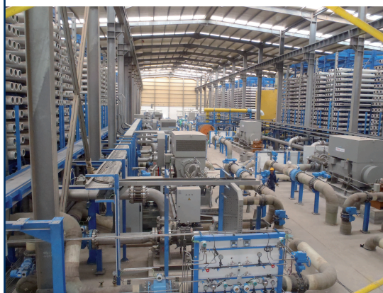
Sala de ósmosis en Mostaganem, Argelia.
