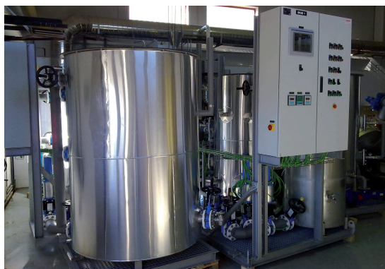
Proyecto de valorización sostenible de lodos. EDAR de Salamanca.
